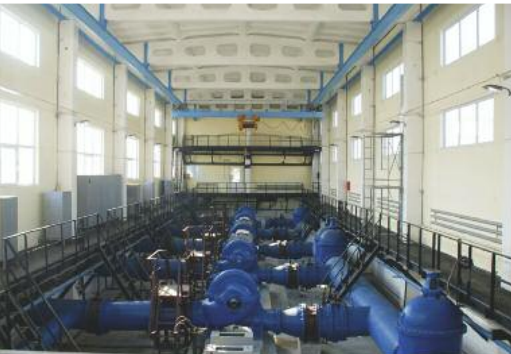
Station de pompage réhabilitée, usine de traitement des eaux usées, Andijan, Ouzbékistan
