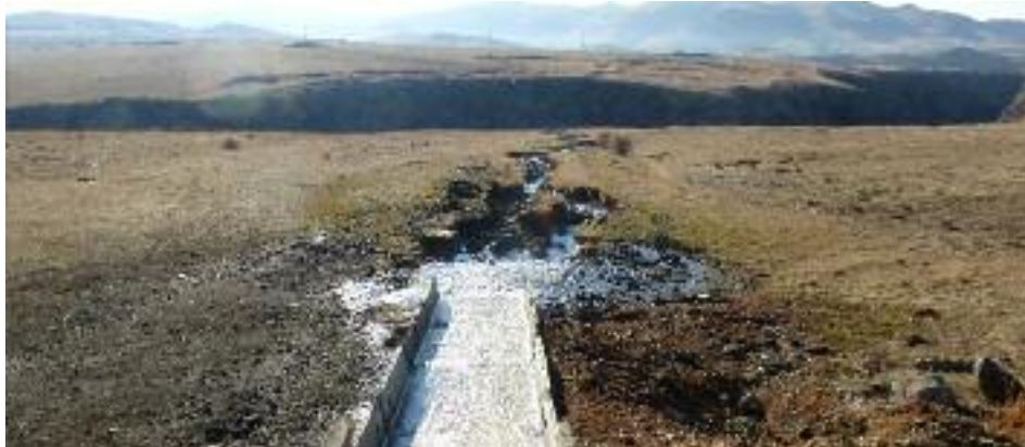
Déversoir du principal canal d'irrigation de la rive droite et problèmes d'érosion en raison de la construction incomplète
