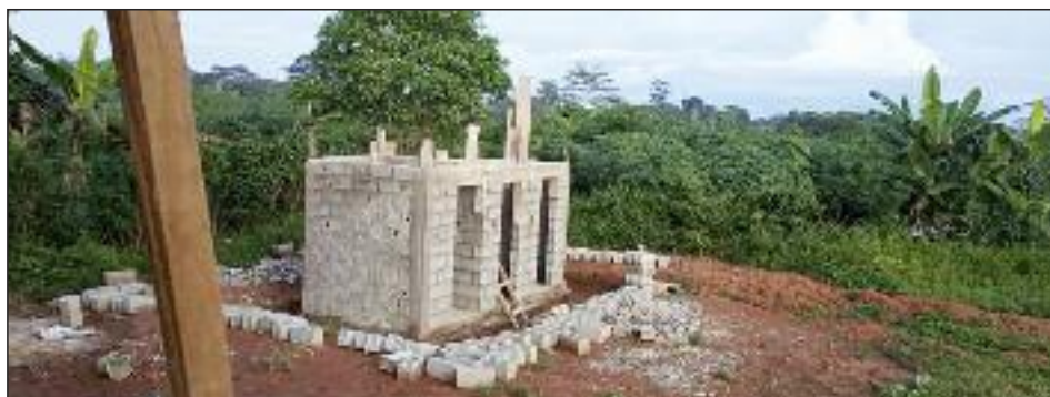
Avancement des travaux des blocs latrine, Lycée de Mintom, Commune de Mintom © Ambero Consulting GmbH
