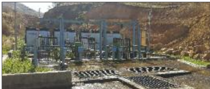
Station de mélange de l'eau recyclée et de l'eau douce en aval du barrage de King Talal, Jordanie
